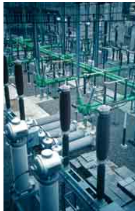
Des champs magnétiques relativement forts sont générés non seulement par les lignes à haute tension mais aussi par les sous-stations implantées à l'intérieur de la clôture.
