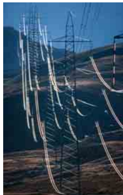
Ligne aérienne de 220 kV près de Laax (GR).
